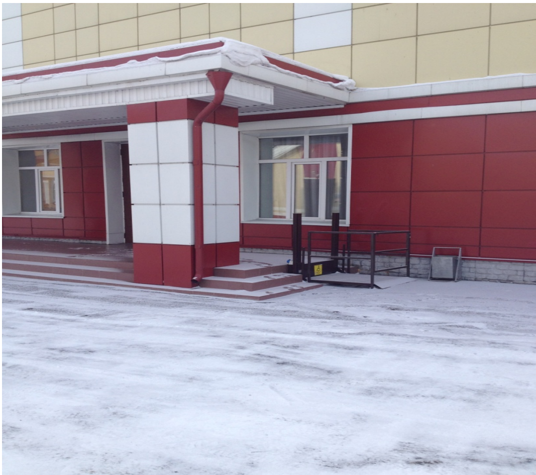
Фото №4 Вертикальная платформа электрического подъёмника - пандуса
